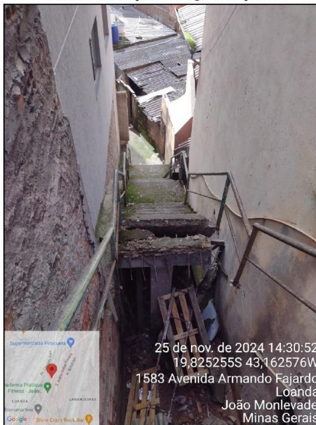
Foto 03: Lance superior de degraus colapsado.
